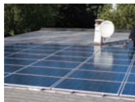
panneaux photovoltaïques à l'horizontale
