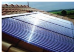
chauffe-eau solaire (panneau thermique)
