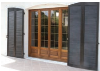
fenêtre et meneaux inadaptés
